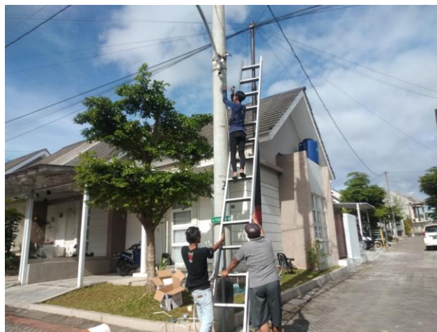
Gambar 2. Gambar Pemasangan IP Camera
